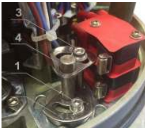
Рис. 5. Блок моментных выключателей
